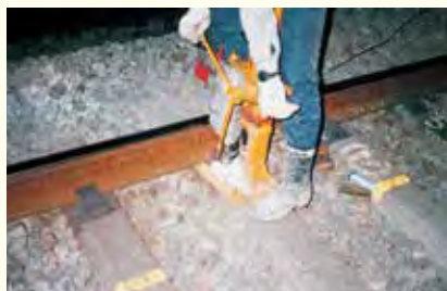
劣化した埋込栓の穿孔
